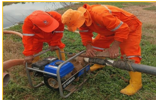
Recirculación en las piscinas
