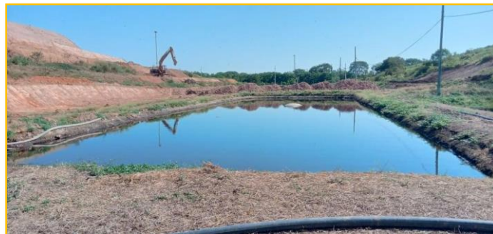
c. PISCINA DE GEOMEMBRANA (P-2)
